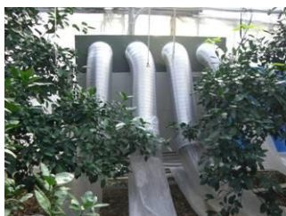
ヒートポンプ式加温機
