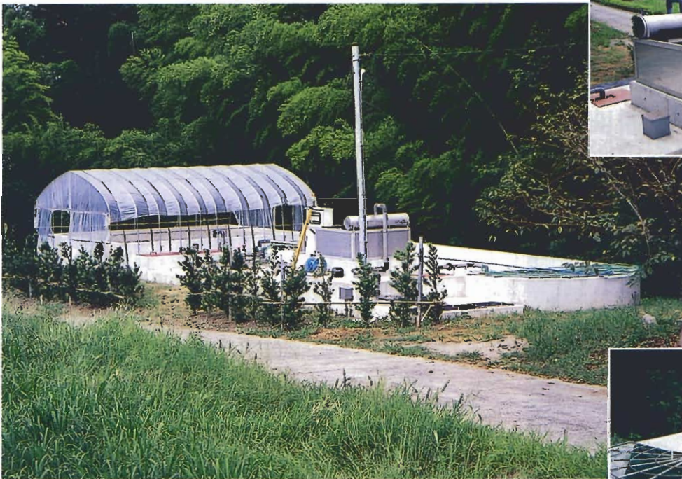
オキシデーション・ディッチ型回分式活性汚泥法污水处理施設
