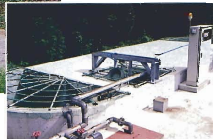
オキシデーション・ディッチ（曝気槽）
