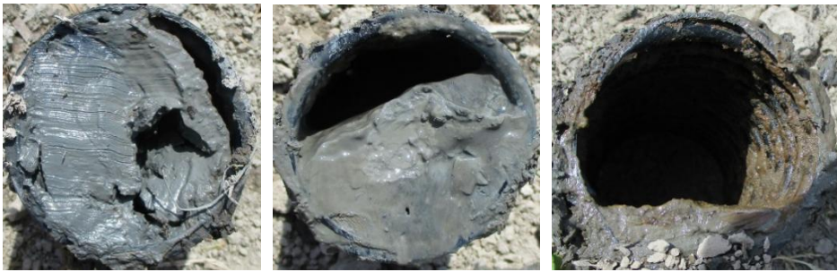
写真4 干拓部門圃場での本暗渠断面・つまりの様子（2016年度成果情報） 左（作業道側）：86.4% 中（中央）：68.4% 右（排水路側）：18.5%
