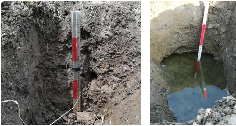
写真6 ー左 施工直後のカットドレーンの跡（2017年10月）、 ー右 施工後4ヶ月目のカットドレーン跡、集水が確認できる（2018年2月撮影）
