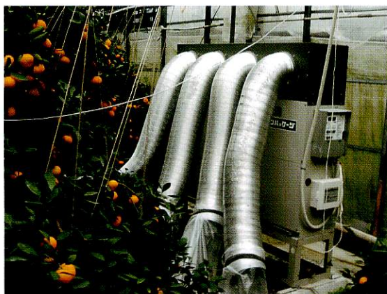
写真1 ミカンハウスの施設園芸用ヒートポンプの室内機
