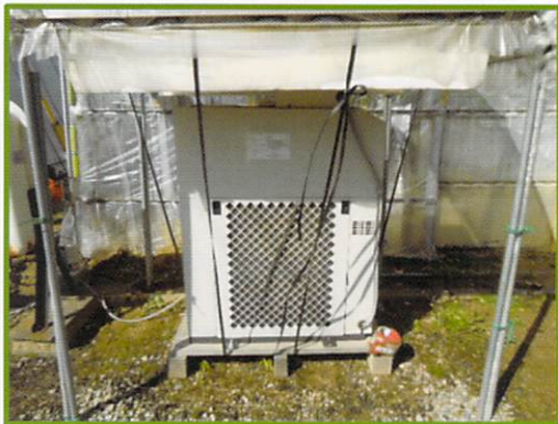
写真4 制御に用いたHPチラー(空冷式)
