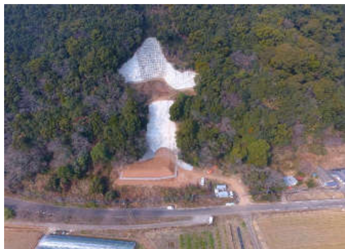
山地崩壊箇所の治山事業による復旧状況（大村市）
