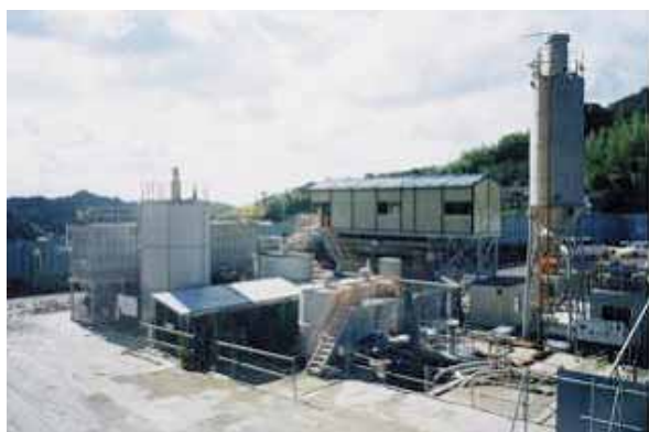
写真1 濁水処理設備（能力：200t/hr）
