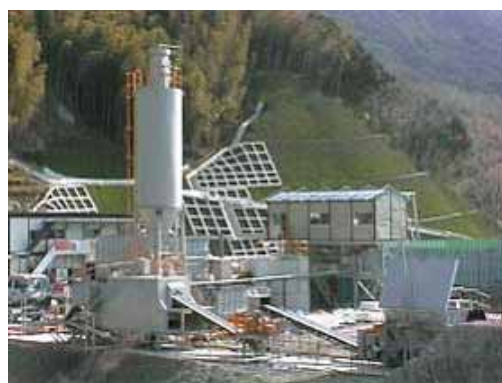
写真2 脱水ケーキ改質設備
