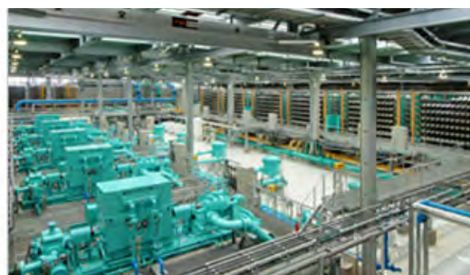
(参考) 海水淡水化施設 (福岡市)
