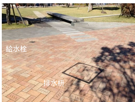
イベント用排水設備の例(宮崎・日向市) イベントに使いやすいように給排水設備を広場や街路内に設置しています。
