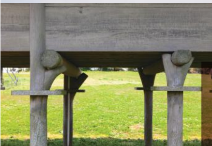
吉岐には真っ直ぐな木が少なく、 建物は枝の分かれ目を上手に 使って建てられた。米を守るための ねずみ返しもご覧の通り。
