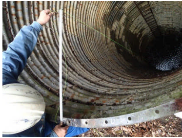
既設集水井戸の傾き
