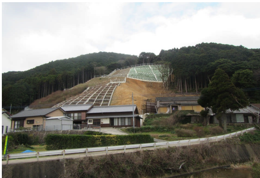
小川原地区急傾斜地崩壊対策工事（平成24年度から平成33年度まで）
