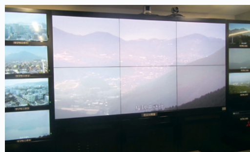
防災対策室の大型モニター
