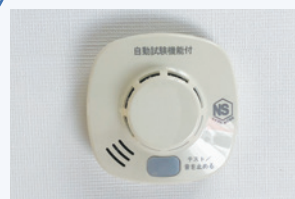
住宅に設置されている住宅用火災警報器の一例
