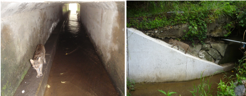
希少野生動物に配慮した道路構造物を利用するツシマヤマネコ 出典：「ツシマヤマネコに配慮した道路工事ハンドブック」 (対馬野生動物交通事故対策連絡協議会)
