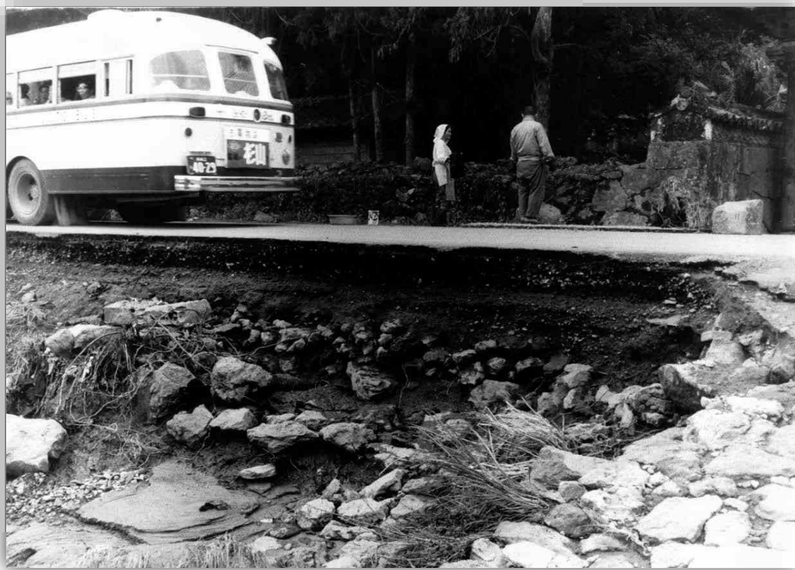
県道の路肩が流出しバスが通るのも危ない状況であった
