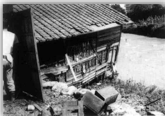
濁流により住宅の壁が失われた
