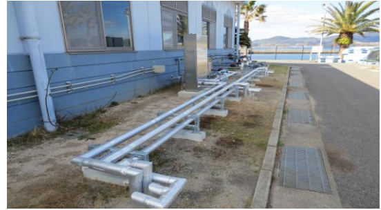
試験区 1 地中熱ヒートポンプシステム
