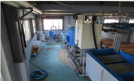
試験区 1 区 電解装置, 活性炭槽
