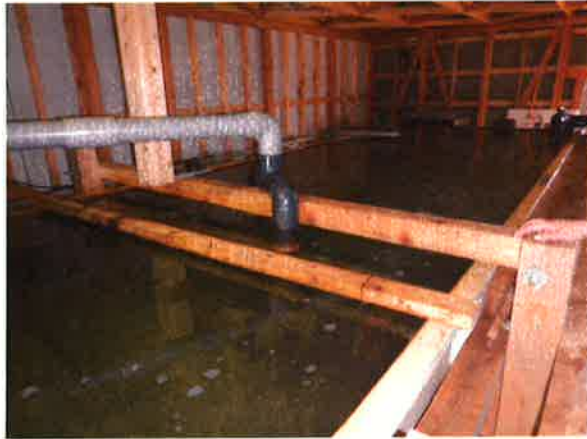
パイプの中にナノバブル発生装置
