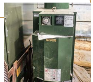
環境制御装置
