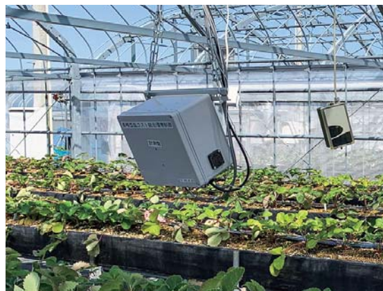
いちごの環境制御装置
