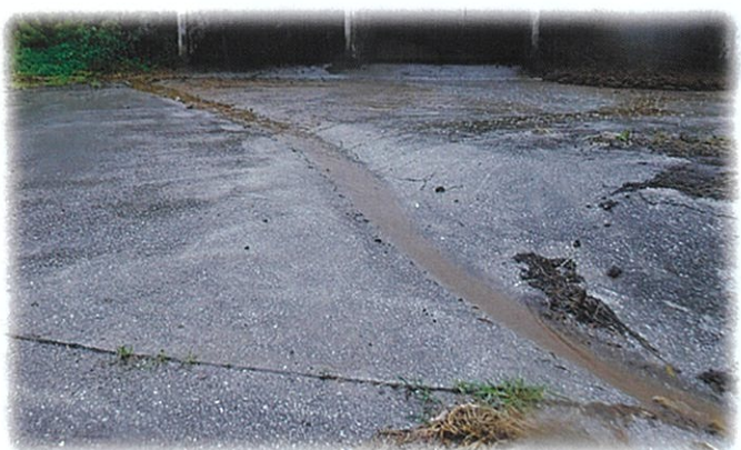
堆肥舎から露出した堆肥の雨による流出
