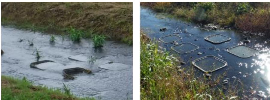
図16 施設1-2 施設の浮上、水面からの露出
