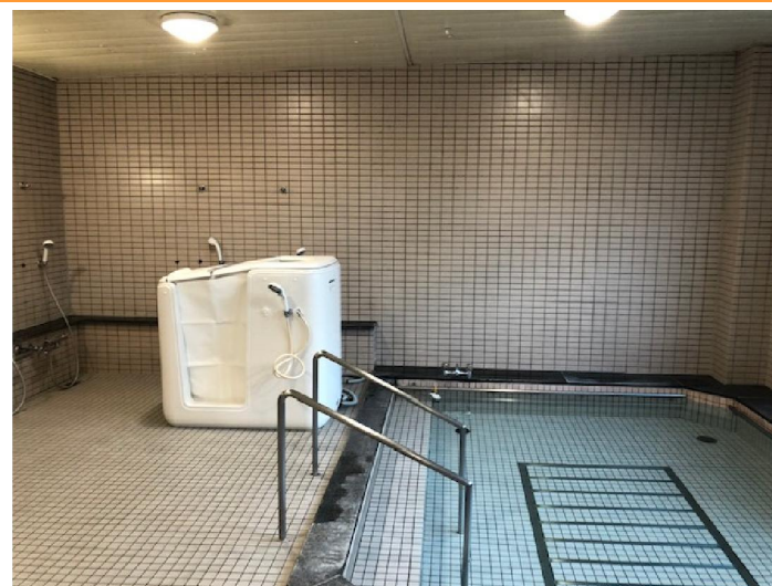
長野県 障害者支援施設 H施設様（浴室）
