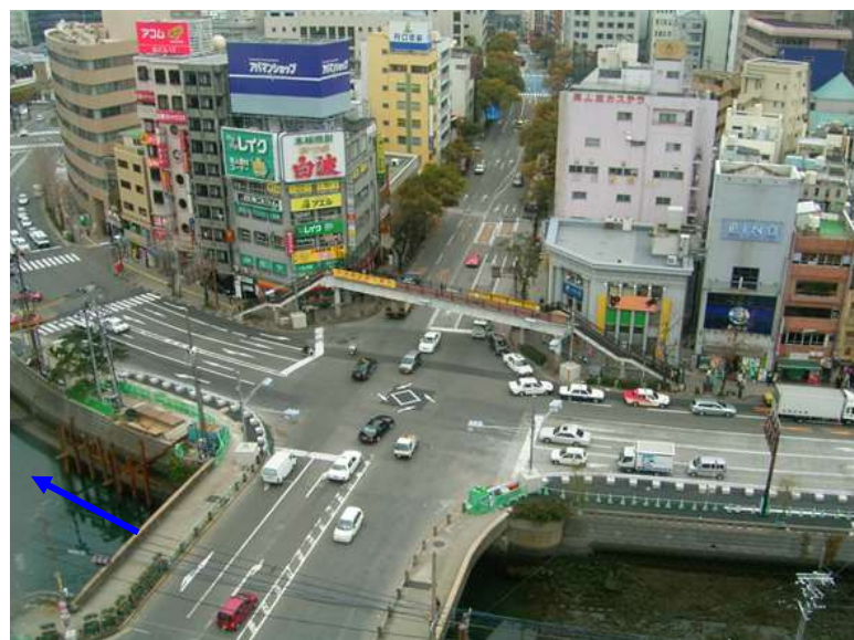
(仮設横断歩道橋設置：平成19年3月) 橋梁工事に支障となる横断歩道橋を撤去し、仮設横断歩道橋を設置
