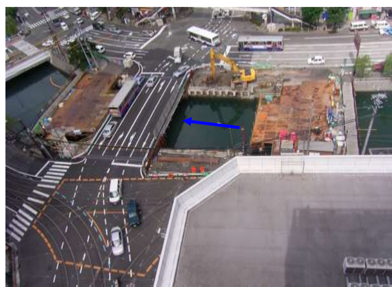
(橋梁上流側施工：平成21年1月) 上流側施工時は、出来上がった下流側の橋梁を迂回路として利用。
