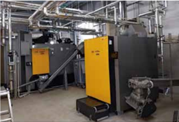
実証事業で導入したチップボイラ
