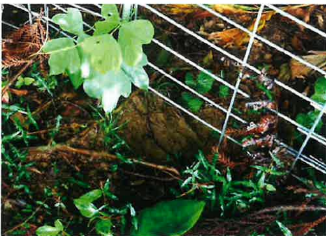
ワイヤーメッシュ下部の隙間
