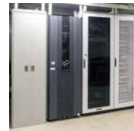
■機器室の通信装置
