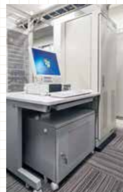
■統制局制御装置
