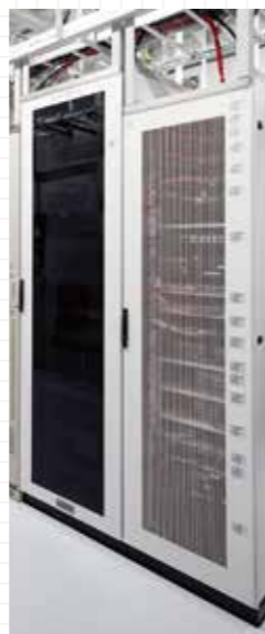
■IPネットワーク装置 ■被遠方監視制御装置
