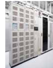
■無線室の通信装置
