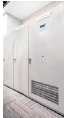
■直流電源装置・蓄電池
