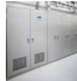
■直流電源装置・蓄電池
