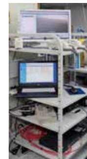
■防災情報端末、映像表示 モニター、半固定型無線装置
