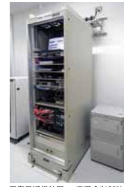
■衛星通信装置、一斉受令制御装置、 小型交換機
