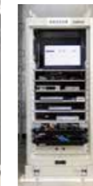
■衛星通信設備
