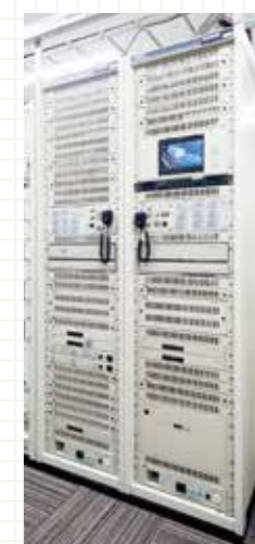
■ヘリテレ監視装置
