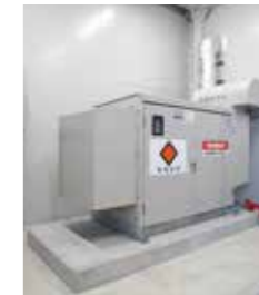
■非常用発動発電機
