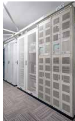
■多重無線装置、遠方監視装置、 防災情報・気象情報装置
