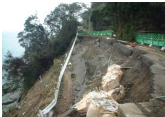
平成18年9月の台風による旧道の被災状況
