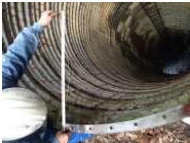
既設集水井戸の傾き
